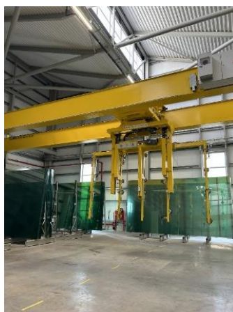
Figura 12 - Ponte do armazém automático que alimenta as mesas de corte.
