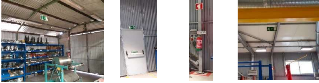
Figura 61. Sinalização de evacuação no setor T5c e T6c.
