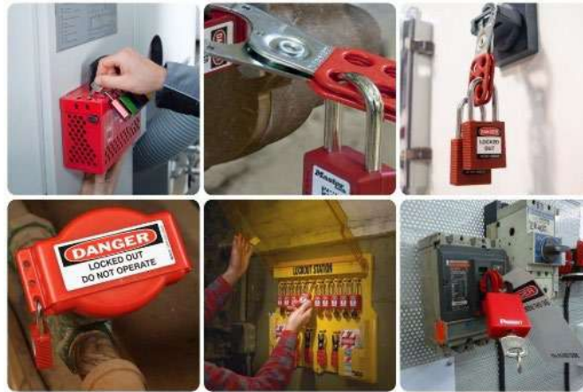
Figura 7. Representação de alguns procedimentos LOTO na manutenção de válvulas, condutas e quadros elétricos.
