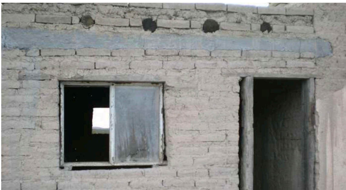
Ilustração 61 – Estado deteriorado das habitações. (TOA, 2020)
