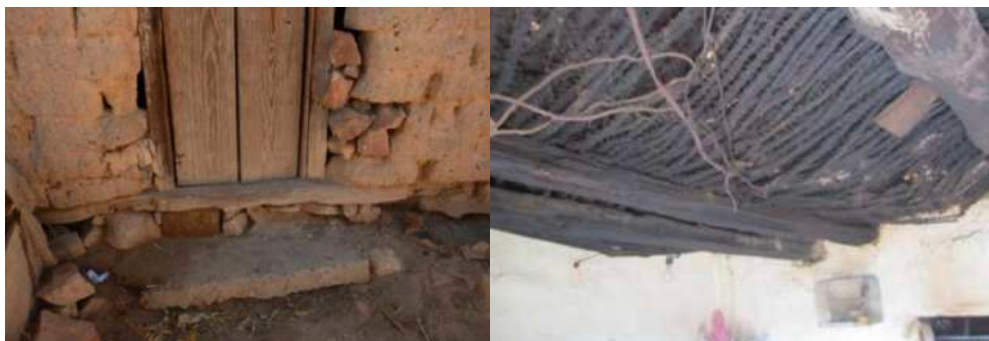
Ilustração 62 – Pormenores do mau estado das habitações da comunidade. (TOA, 2020)
