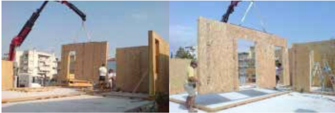
Ilustração 63 – Montagem de paredes portantes aligeiradas, Loghomes. (Laboratório Nacional de Engenharia Civil, 2011, p. A5.19).
