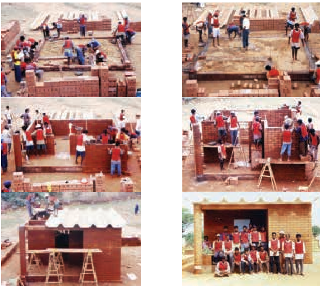
Ilustração 38 –Etapas de construção da casa móvel Aum, BTC perfurados, em Khavda na Índia. (Auroville Earth Institute, 2020).
