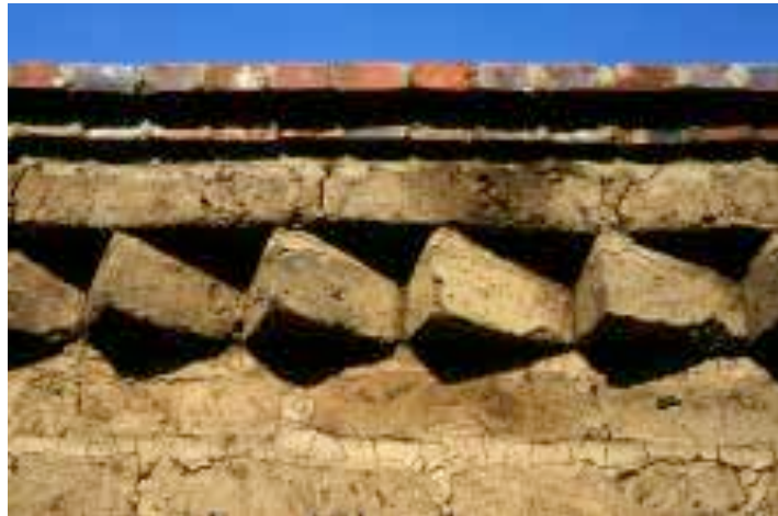
Ilustração 41 – Início de degradação de parede em adobe por exposição à água, Herbert Baresch. (Baraya, 2020).
