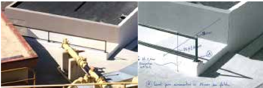
Ilustração 60 – Zona da Culatra - guarda metálica a corrigir (Ilustração nossa, 2018)
