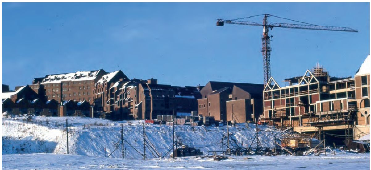
7 - À esquerda, edifícios assentes em terreno natural. À direita, construídos sobre a laje.
