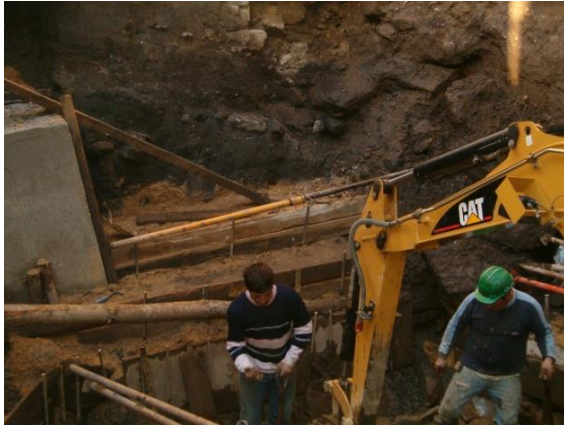
Figura 28: Maciço de betão e socalcos para contenção de terras
