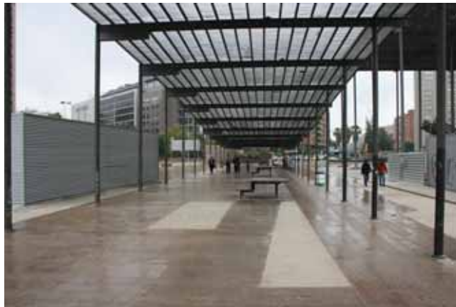
Figura 36 – Praça dos Países Catalães, piso remendado sob estrutura ondulada.
