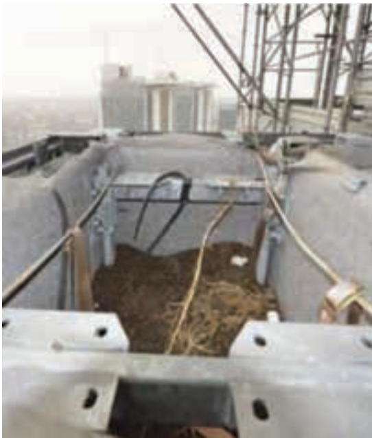
Ilustração 84 – Vista do interior do dispositivo de contenção com a tela de impermeabilização e a chapa protetora. (Giacomello, 2015, p. 17)
