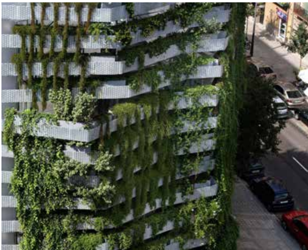
Ilustração 111 – Estrutura metálica já com vegetação. (Mazzocchi, 2012)
